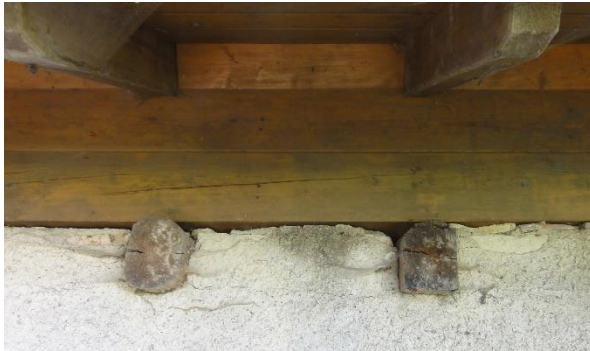
Abbildung 9: Spalten und Hohlräume an der Fassade
