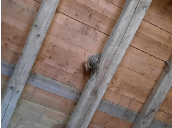
Abbildung 7: Ehemaliges, vom Hausrotschwanz überbautes Rauchschnalbenest im Stall
